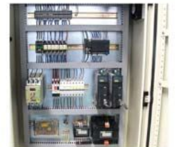
电气系统 Electrical System
